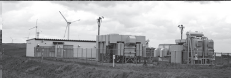
▲宗谷岬ウインドファームの構内変電所
