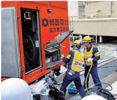
必要な設備に電気を供給するため、電源車から電源盤にケーブルを接続、電源を復旧する訓練
