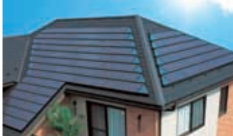
屋根に設置した太陽電池モジュール
