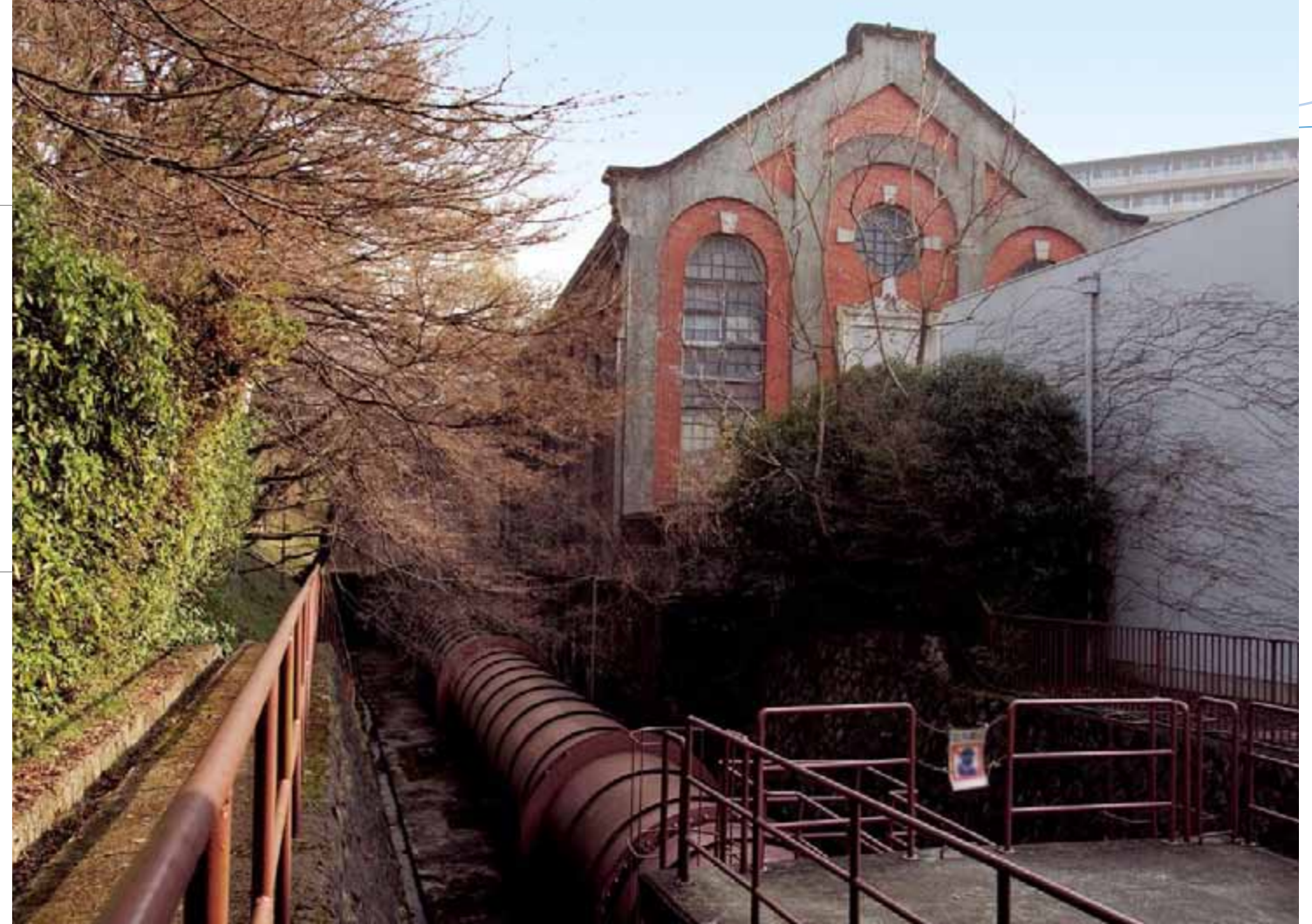
琵琶湖疏水から蹴上発電所(第3期)に水を引いている管
