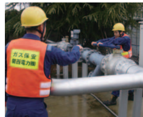
緊急時のガス供給弁閉止の訓練
