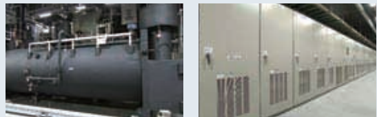
高効率電気式ターボ冷凍機
