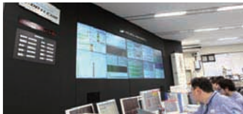
24時間365日体制の監視、運用、保全（SOC）
