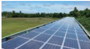
太陽光発電設備
