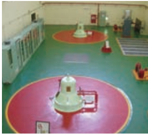
名間水力発電所の内部
