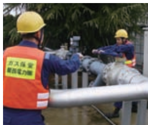
緊急時のガス供給弁閉止の訓練
