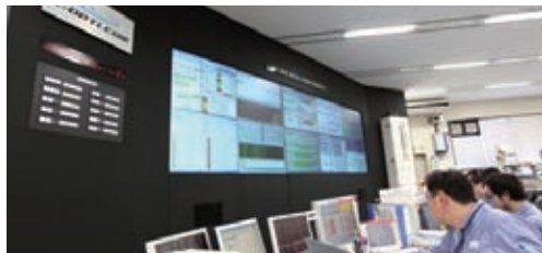
24時間365日体制の監視、運用、保全（SOC）
