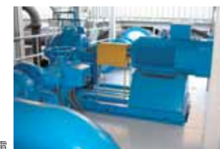
豊中市寺内配水場小水力発電
