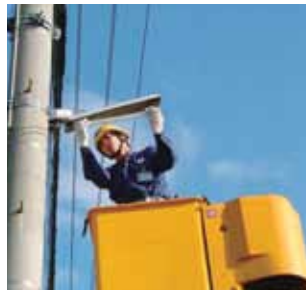
「外灯点灯運動」の一環で地域の街灯清掃・点検を実施 (滋賀営業所)
