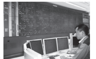
基幹系統給電所
