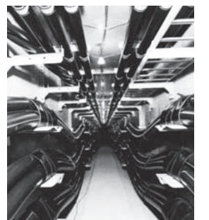
南港火力線洞道（上が水冷管、下が電力ケーブル）
