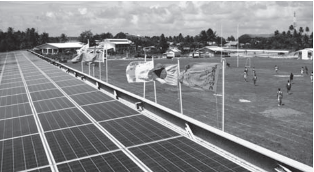
ツバルでの太陽光発電プロジェクト
