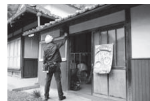
高齢者宅の電気設備点検
