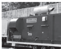
空冷式非常発電装置
