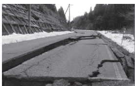
陥没し寸断された道路
