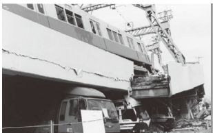
鉄道高架の倒壊
