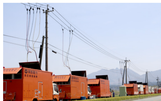
応急送電をおこなう高圧発電機車（イメージ）（2016年4月）
