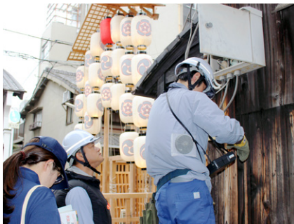
祇園祭山鉦の配電検査
