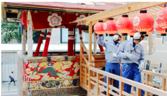
祇園祭山鉾の配電検査
