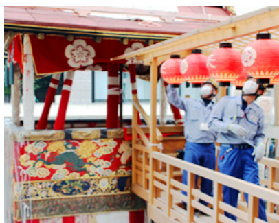
祇園祭山鉾の配電検査
