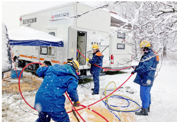
高圧発電機車で応急送電の様子
