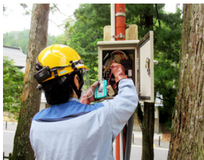
高野山の電気設備点検
