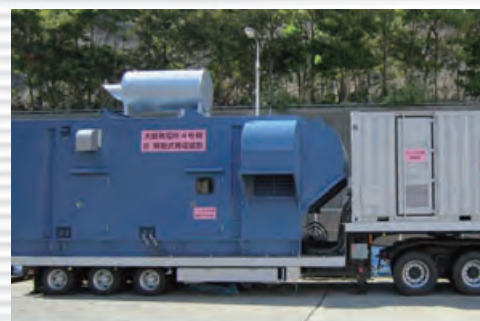
空冷式非常発電装置
