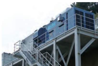
●空冷式非常用発電装置
