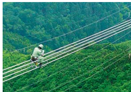
●送電線のメンテナンス
