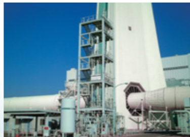
●南港発電所排煙脱炭プラント
