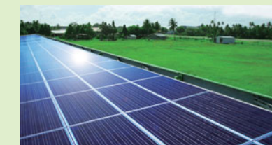
●サッカー場に設置した太陽光発電設備
