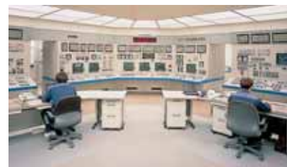
●原子力発電所中央制御室
