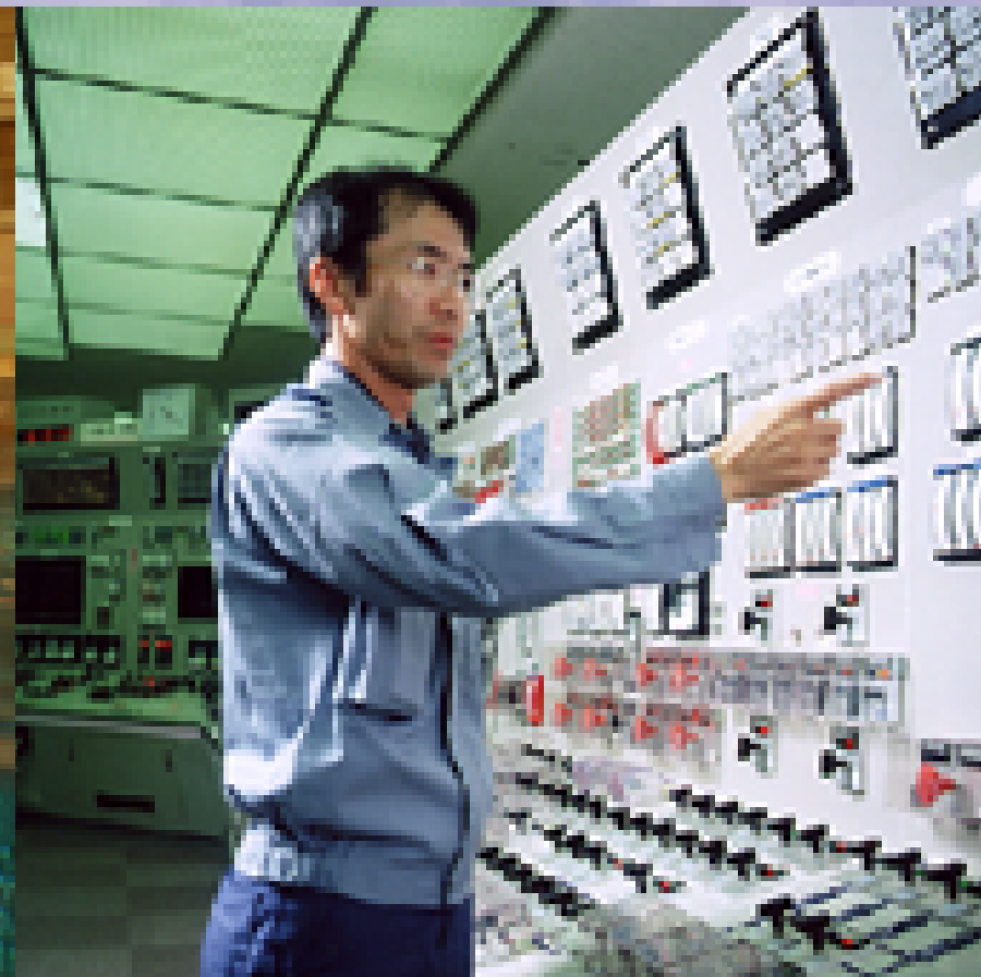
高浜発電所中央制御室
