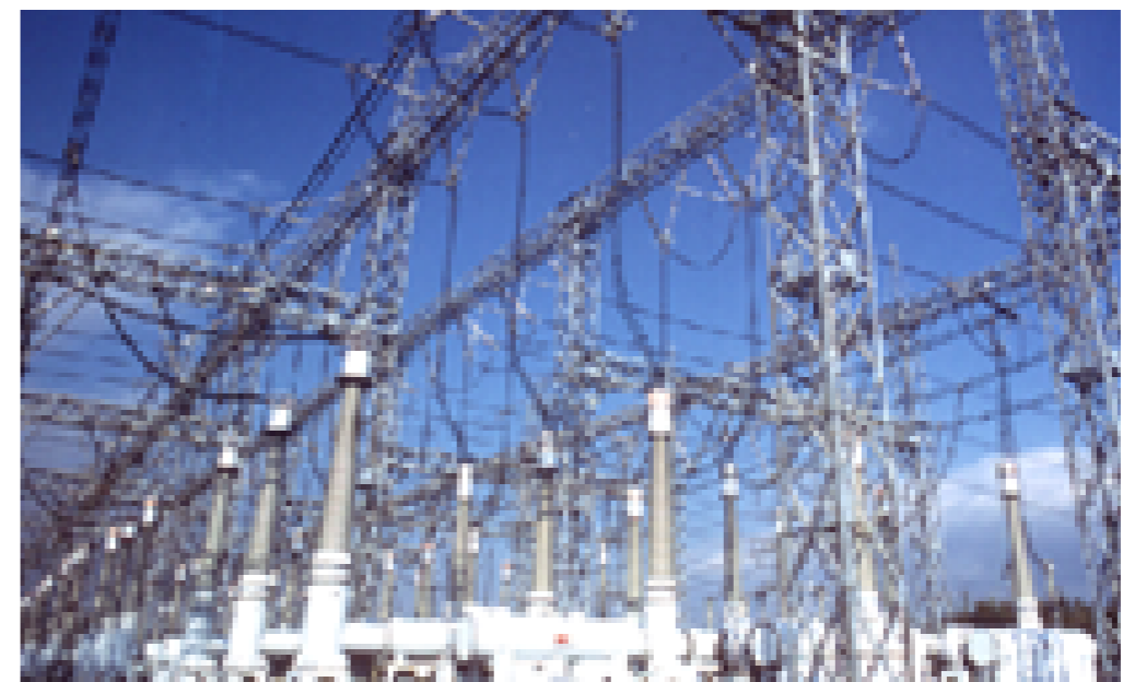
新生駒変電所
