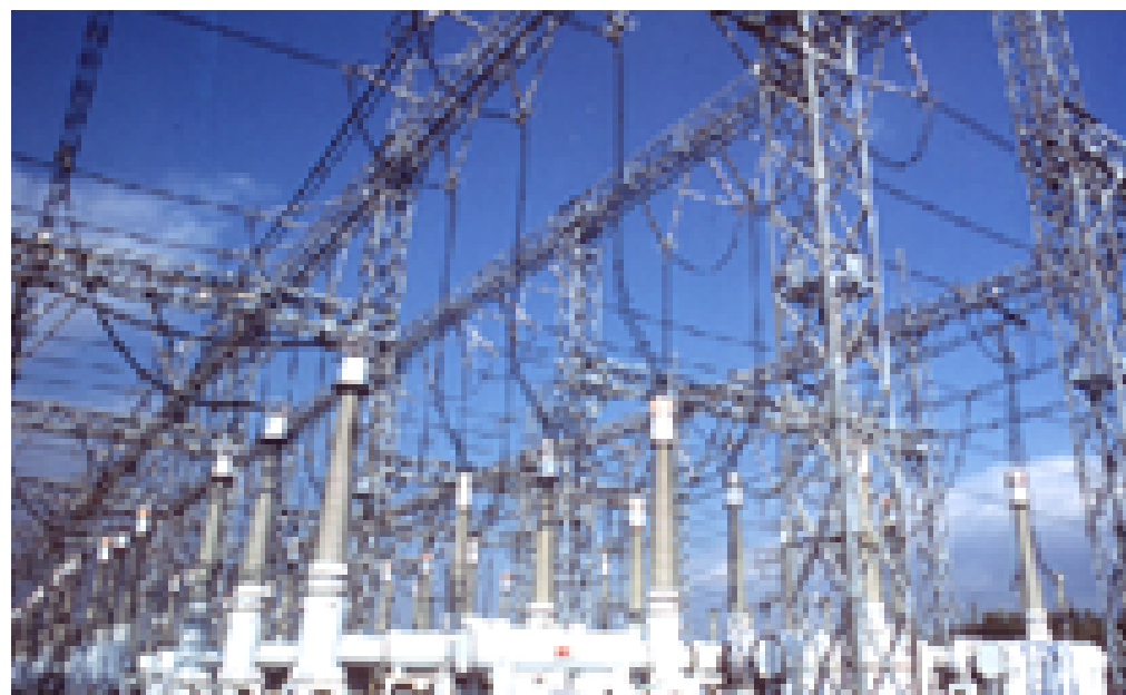
新生駒変電所
