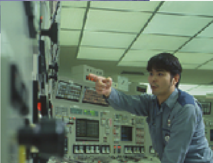
高浜発電所中央制御室
