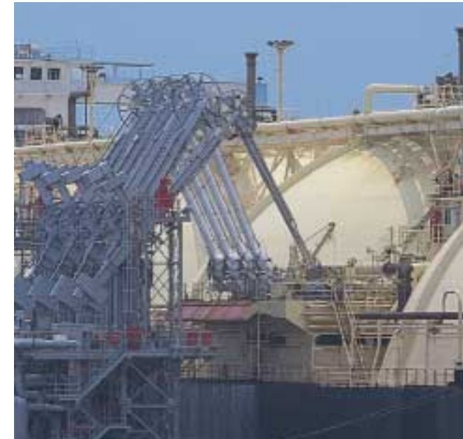
LNG ship and loading arm.
