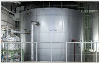
メタン発酵槽 (省スペース型)
