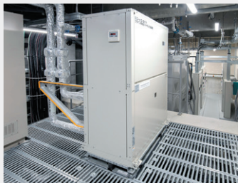
下水熱ヒートポンプ
