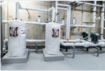
膨張タンクと熱源水ポンプ
