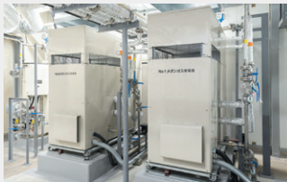
バイオガス発電のマイクロコジェネレーション
