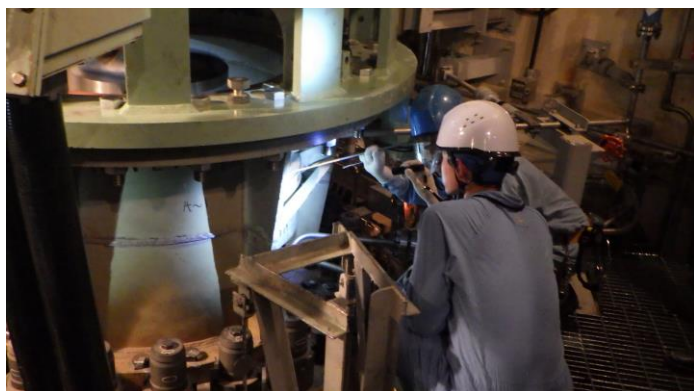
高浜2号機再稼動時の現場点検の様子 (1次系冷却材ポンプの運転状態の確認)
