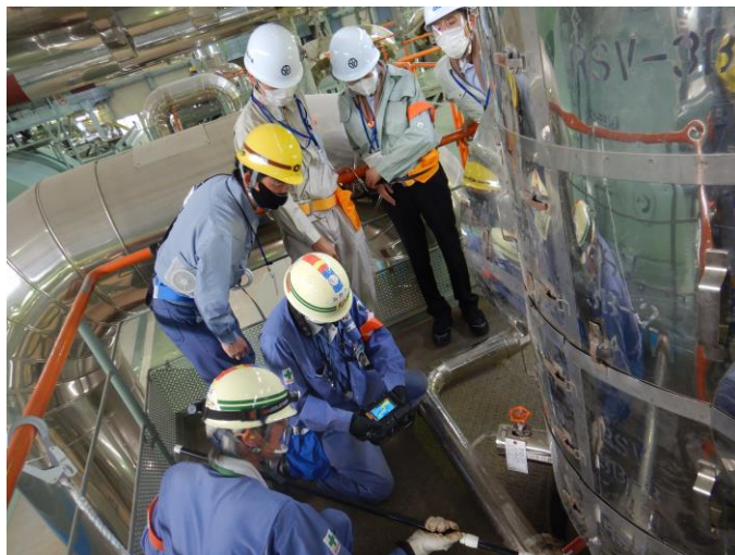
美浜発電所起動工程点検の様子
