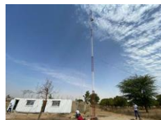
通信用アンテナ
