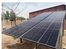
太陽光パネル
