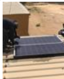
屋根に設置した 太陽光パネル
