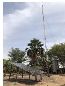
太陽光パネルと 通信用アンテナ
