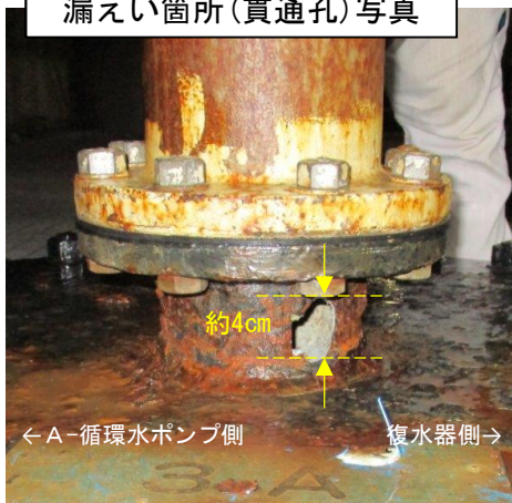
漏えい箇所(貫通孔)写真
