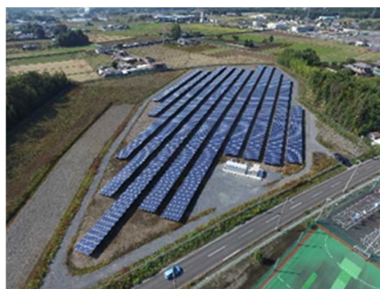
ハル水戸太陽光発電所
