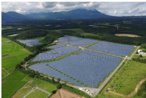
雫石太陽光発電所
