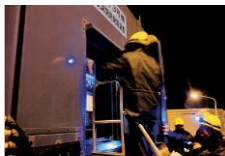
夜間における 接続・起動訓練
