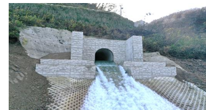
加須良川引水設備
