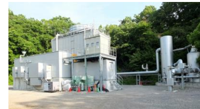
わいた発電所
