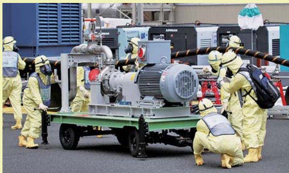
可搬式代替低圧注水ポンプを配置
