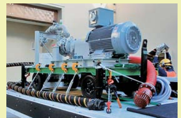
可搬式代替低圧注水ポンプ (福島第一原子力発電所事故後に新設)
