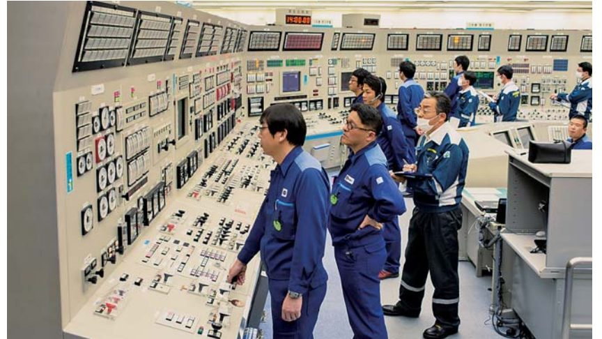
高浜3号機発電、送電開始（並列）時の中央制御室の様子（2月1日）
