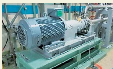
恒設代替低圧注水ポンプ
