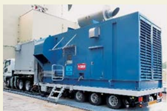
空冷式非常用発電装置
