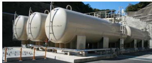
【大飯発電所3,4号機消火水系統バックアップタンク設置工事(平成27年8月完了)】
