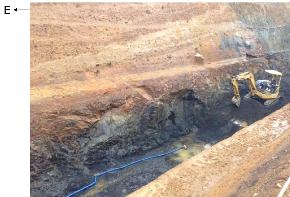
壁面崩壊発生状況 (H24.12.11 撮影)
