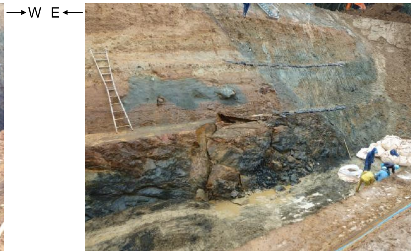
岩塊すべり発生状況 (H24.12.11撮影)
