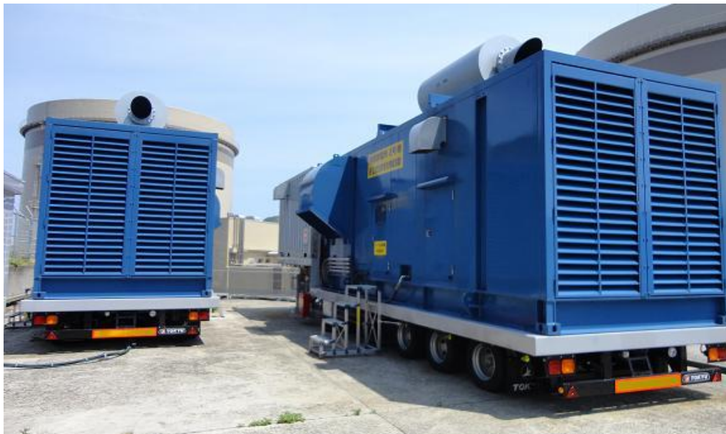
空冷式非常用発電装置
