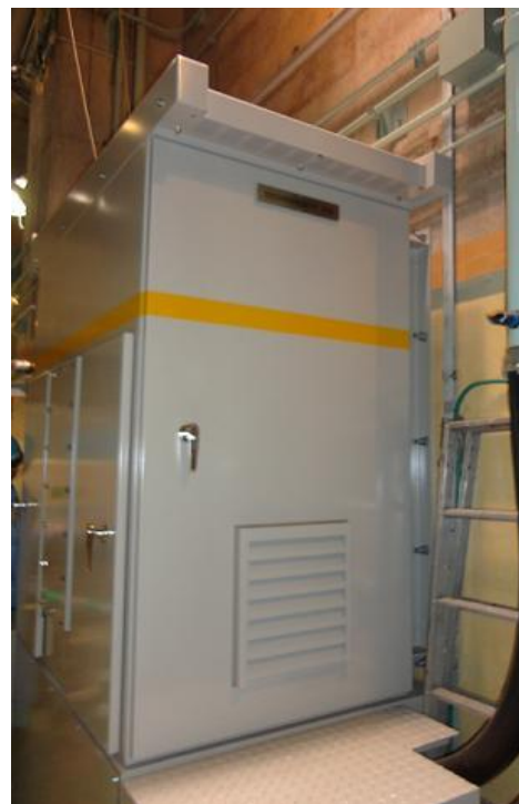
中継・接続盤
