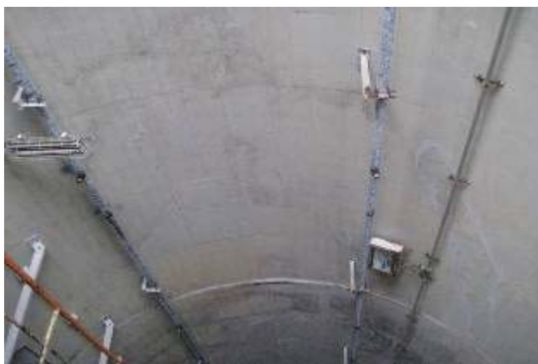
陀羅山トンネル内頂部の配管
