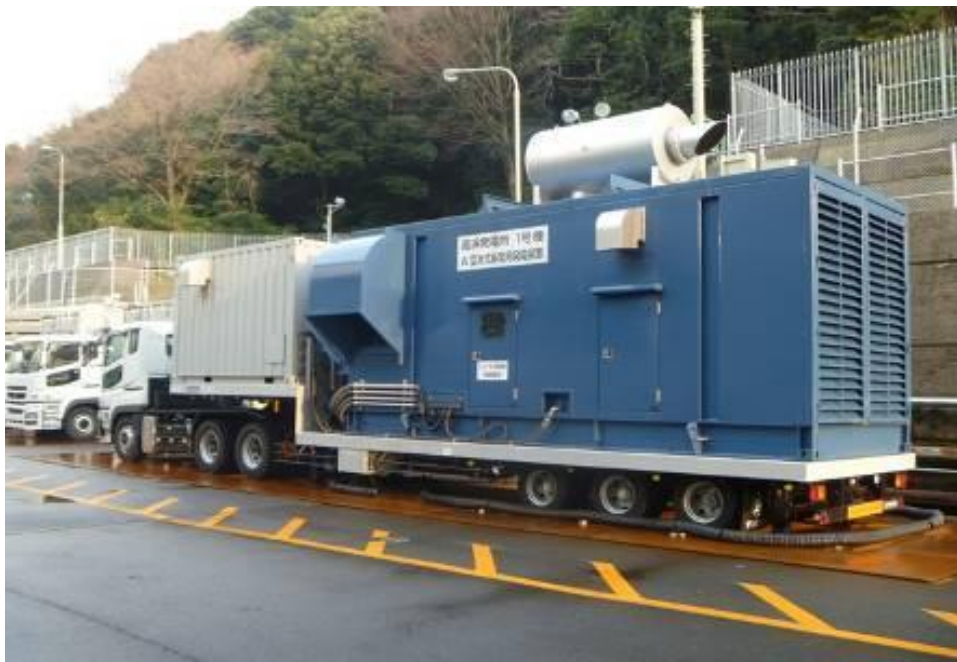
空冷式非常用発電装置
