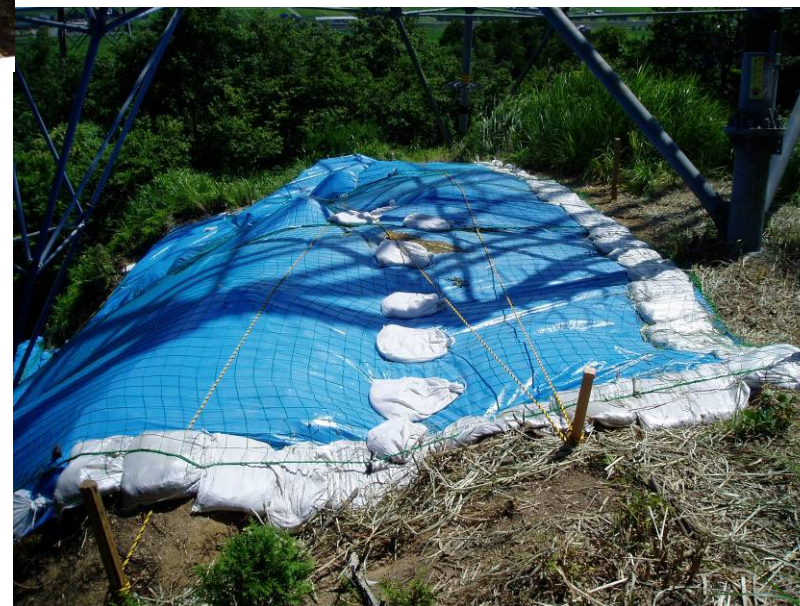
(今後の対応) 恒久対策としてのり面保護工を実施予定。
