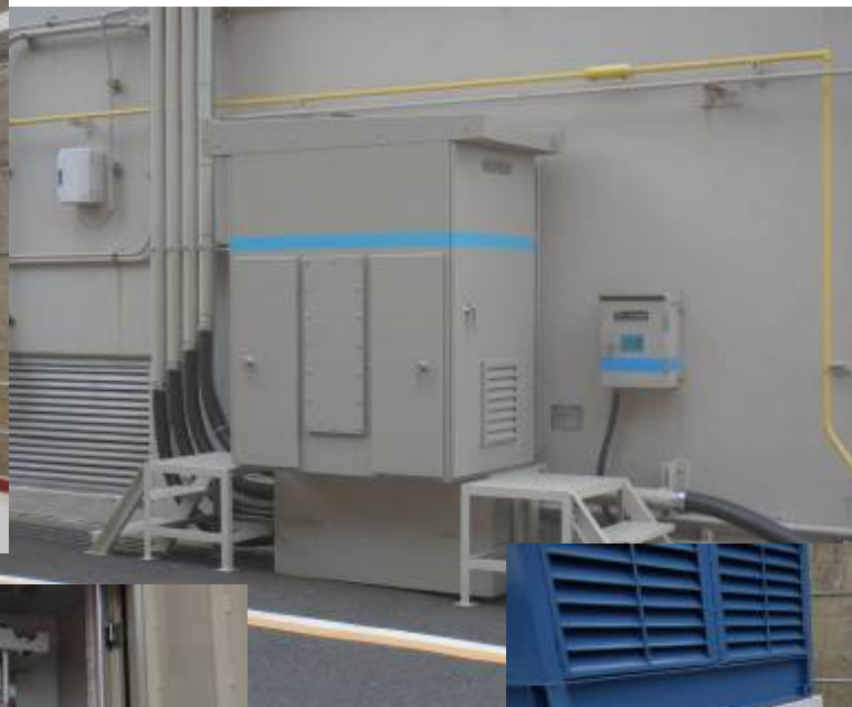
中継・接続盤
