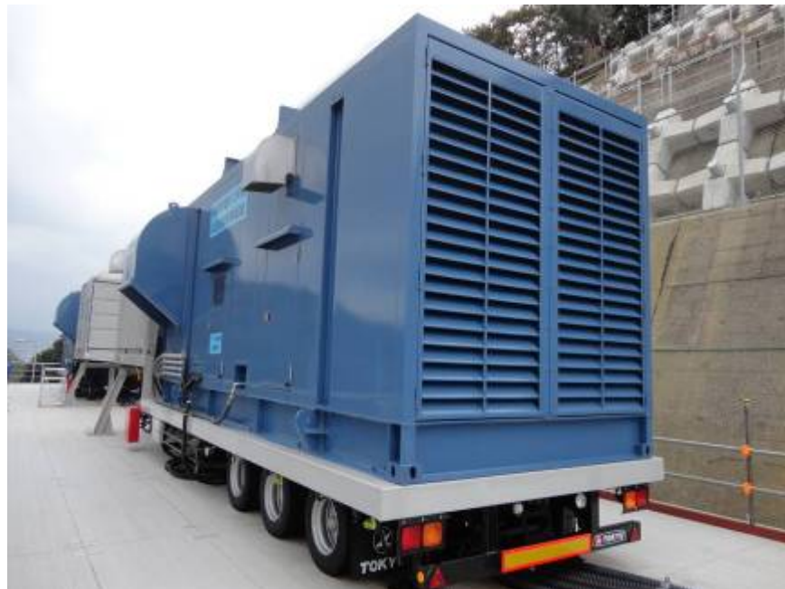
空冷式非常用発電装置
