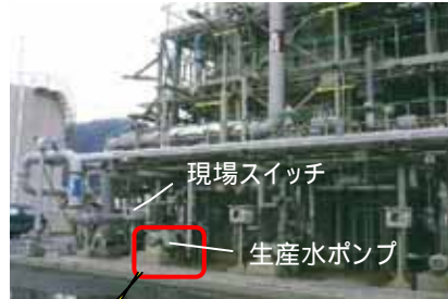
発生場所写真(海水淡水化装置)
