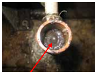
オイルカップ接続配管内の写真
