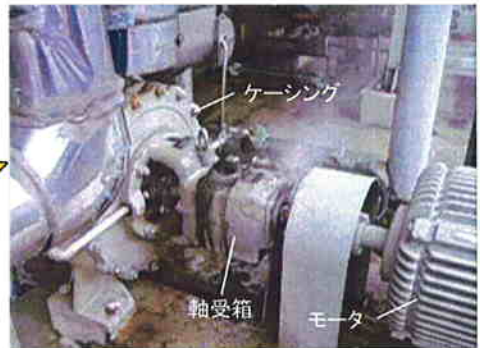
消火後に撮影した B-海水淡水化装置生産水ポンプ軸受箱部の写真
