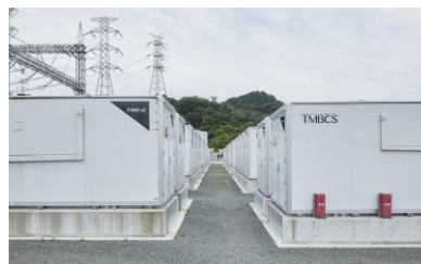
紀の川蓄電所 (2024年運用)
