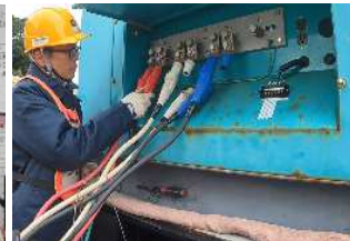
電源車（緊急時対策所用） 準備・給電訓練
