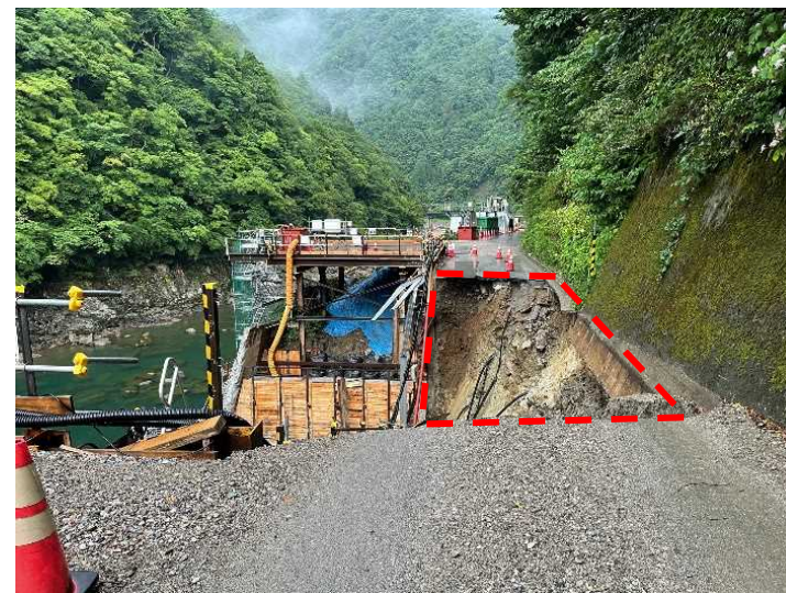
【市道の損壊の状況】
