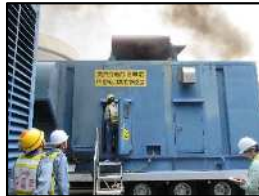
空冷DG起動操作
