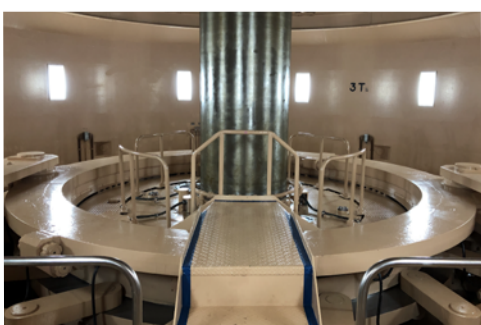
■奥多々良木発電所 3号機
